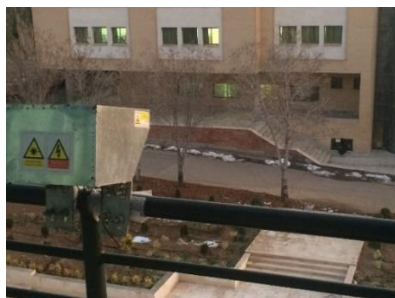
تصویر ۲: سیستم بازتابنده نصب شده در ساختمان علوم طبیعی
